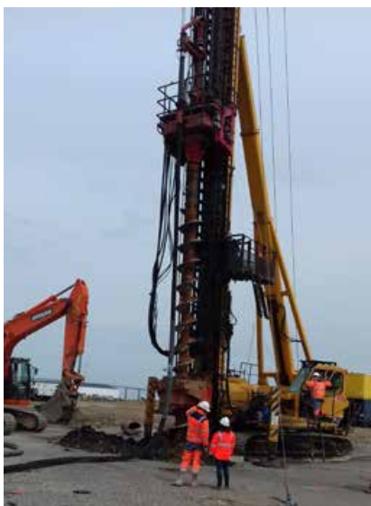
Forage des pieux de type Starsol par l'entreprise Soletanche Bachy Fondations Spéciales.
